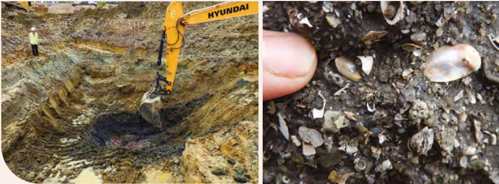
À gauche: À Kourou, près du lanceur ELA4, une pelleteuse atteint la base de la série sédimentaire pléistocène (argiles fossilifères, gris sombre) et atteint le socle altéré (saproлите, rose). À droite: Vue détaillée des argiles fossilifères marines, âgées d'environ 125 000 ans. Le doigt pointe un otolithe de poisson (pièce intracrânienne minéralisée). © Antoine P.-O.
